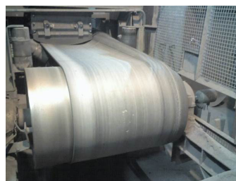
Före installation av Tru-Trac
